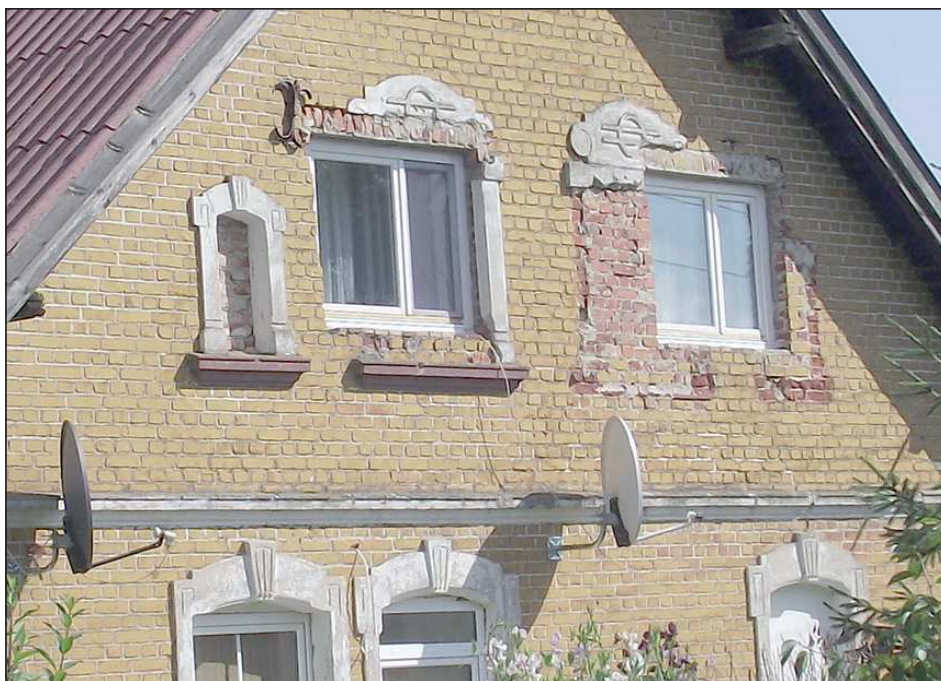
Rys. 3. Ubożenie elewacji budynku mieszkalnego w wyniku niewłaściwego umiejscowienia nowych otworów okiennych, Durąg, wrzesień 2011 r. (fot. archiwum KNAK „Horyzont”) Fig. 3. Depletion of the facade of a residential building due to improper siting of new window openings, Durąg, September 2011 (phot. KNAK „Horyzont”)
