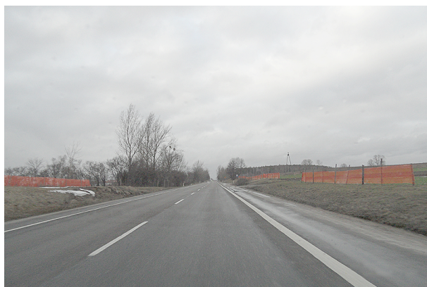
Rys. 1. Sztuczna osłona przeciwśnieżna na poboczu drogi
